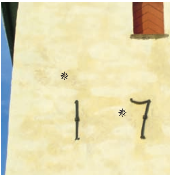
Kalkfärg som har målats på tät yta har en tendens att försvinna snabbt. Här syns kalkfärgade lagningar där färgen försvunnit.
