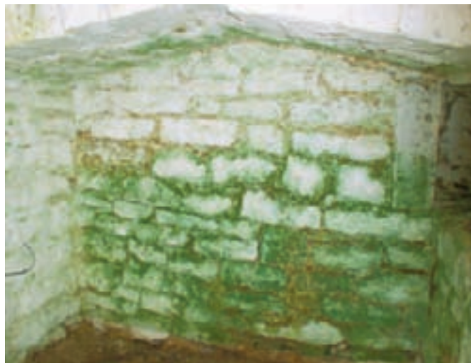
Gröna alger indikerar fuktiga murverk.
