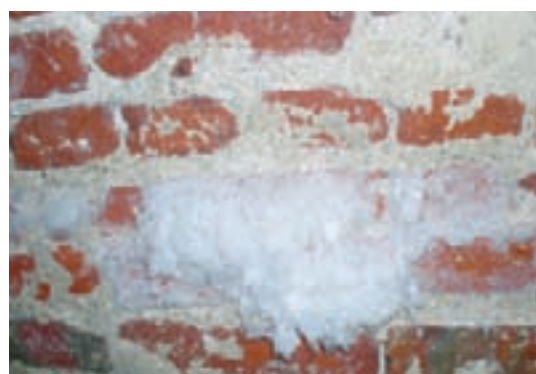
Salt som har kristalliserat utanpå murverket bildar skäg.
