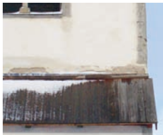
Frostskador i form av bortsprängda putspartier.
