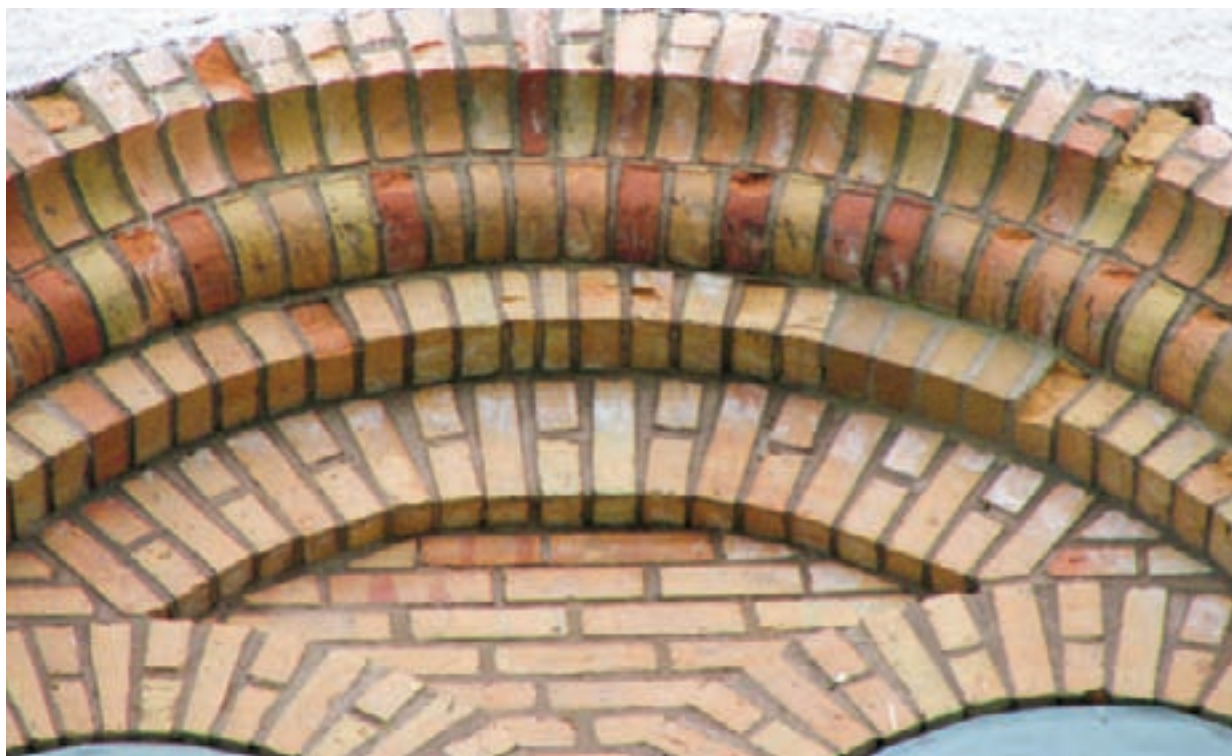
När bruket är starkare än murstenen kan skadan ske i stenen istället för i bruket.
