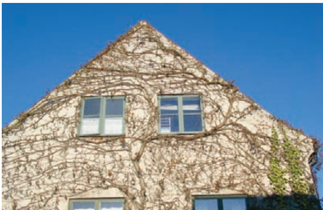
Vildvin och murgröna håller fukten kvar i väggen och växer sig in i sprickor och liknande.
