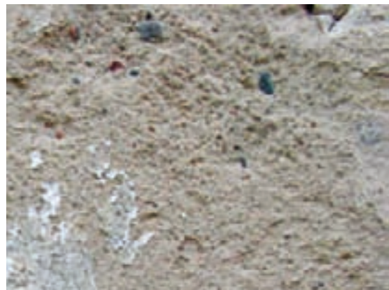
Magert kalkbruk från 1900-talets slut på Linde kyrka, Gotland.
