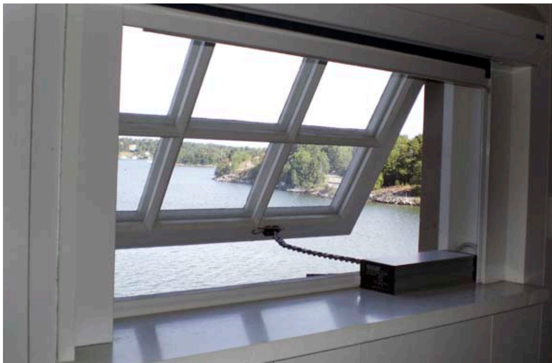
Som ett alternativ eller komplement till självdrag finns automatiska vädringssystem. Dessa är datorstyrda och regleras utifrån vädringsbehov. Vaxholms fästning.
