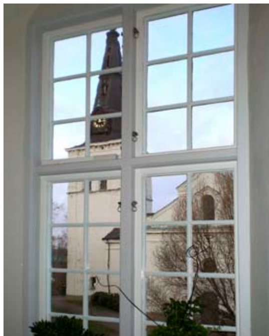
Tilluften till byggnaden sker genom springan som naturligt finns mellan överbågens översida och karmöverstyckets undersida. I övrigt har fönstret försetts med tätninglistor för att förhindra drag.
