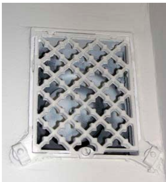
Bakom frånluftsgallren har kontrollventiler för injustering av frånluftsfloëdet monterats.
