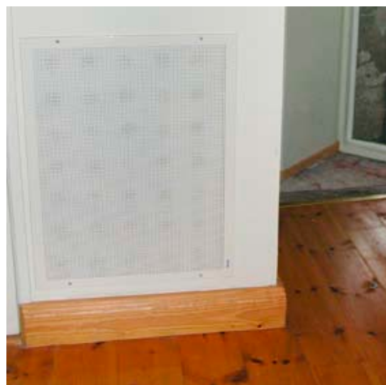
Tillluftsdon i sammanträdesrum på vindsvåningen får sin luft via en tegelkanal som tidigare varit pannskorsten.
