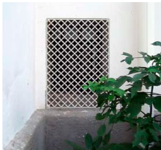
Munchsalens lanterninutrymme kyls numera med sval luft som tas in genom detta nyinsatta galler. Gallret är återvunnet från en tidigare rivning på Manillaskolan.
