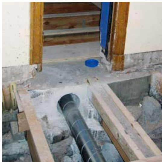
Betonggjutning under dörrtröskel är inte en lösning som RAÄ förordar i en byggnad med träbjälklag. Utförandet krävde RAÄ:s tillstånd till avsteg från skyddsföreskrifterna. Skridskopaviljongen, Kastellholmen.
