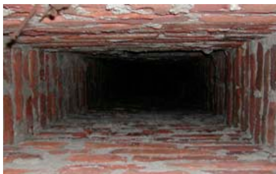
Genom tegelkanaler distribueras den värmda luften uppåt i huset från värmekammaren.
