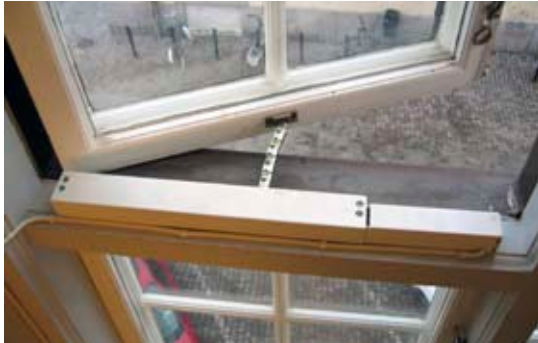
Motor för automatisk öppning av fönstret är placerad på fönstrets tvärpost. Elledningen ligger synligt längs karmen.
