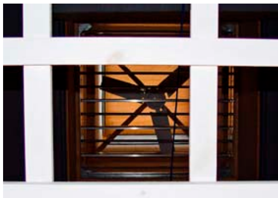
Luftschaktet sett underifrån där axialfläkten skymtar. Med ett rep kan en falllucka regleras för önskat frånluftsflyde, antingen via självdrag eller fläkt.
