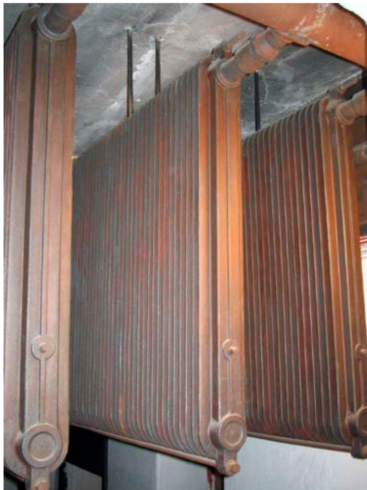
Thielska galleriet har ett ursprungligt kalorifersystem. Radiatorerna i värmekammaren förvärmer tilluften.
