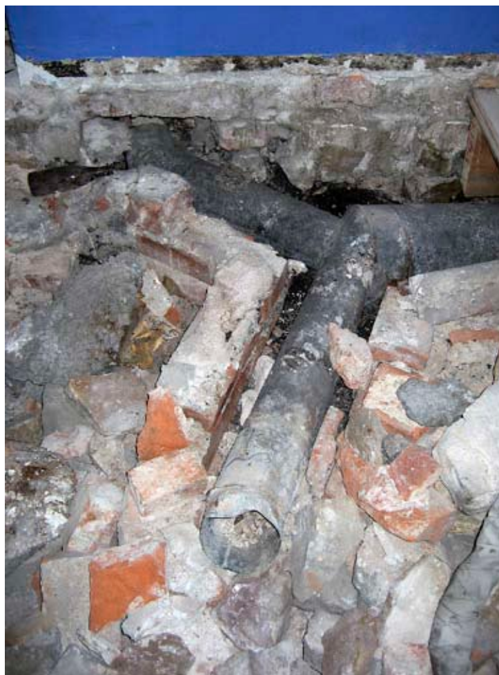
Rester av den ursprungliga anläggningen för luftuppvärmning ska lämnas orörd. Skadade träbjälkar i trossbotten utbyts och nytt trägolv läggs in. Skridskopaviljongen, Kastellholmen.
