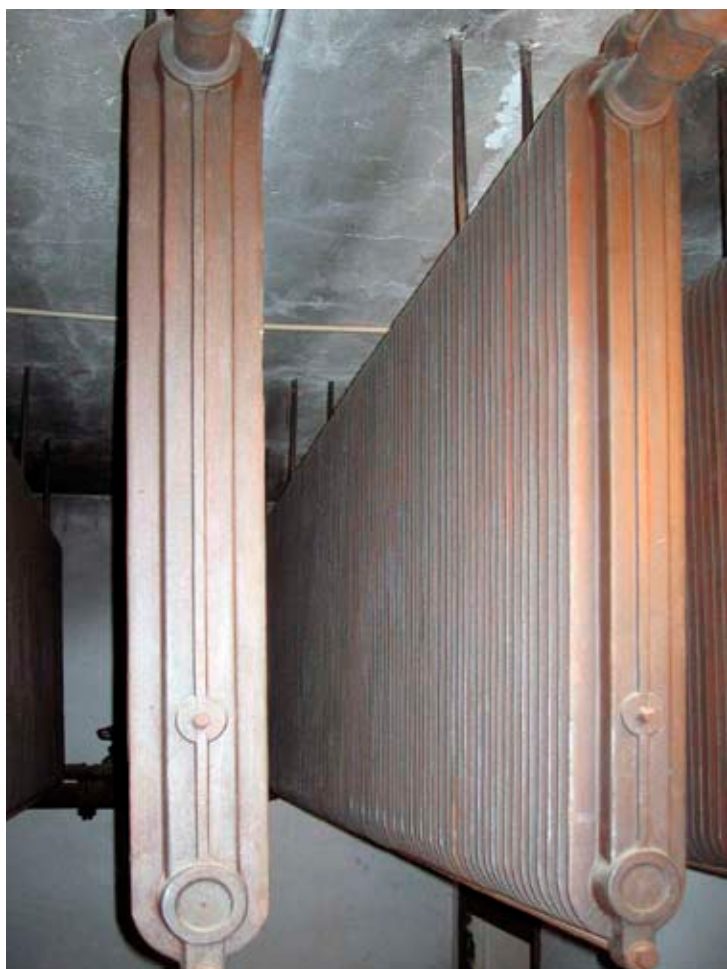
I kalorifersystemets värmekammare värms luften av radiatorer som är monterade i taket.
