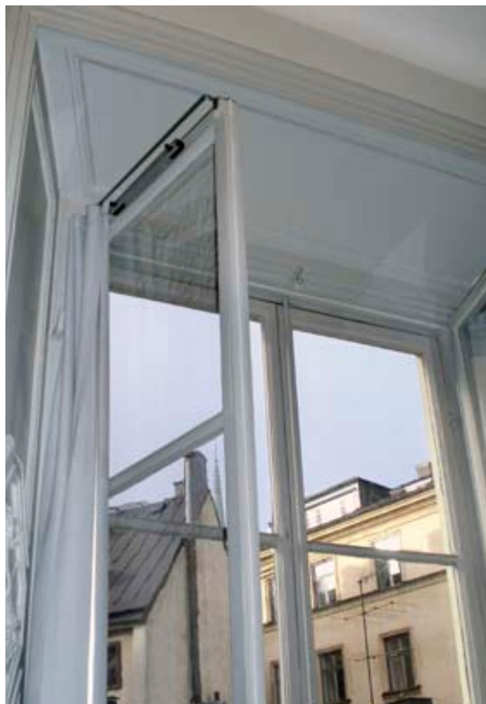
Norra Bancos fönster har inte kopplade bågar. Därför sitter spaltventilerna på de inre bågar. De yttre bågar har inga tätningslistor.
