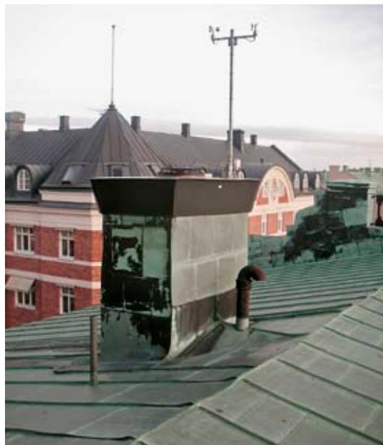
Väderstationen på taket styr fönstervädningssystemet. Givare för vindriktning, vindhastighet, nederbörd och temperatur finns. Inne i byggnaden sitter koldioxidmätare och brandindikator som är anslutna till vädningssystemet.
