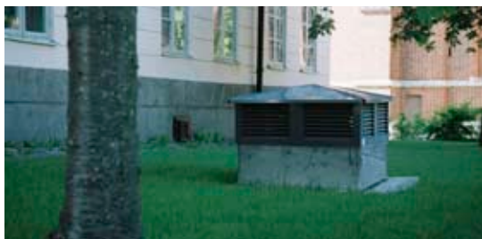
Uteluften tas in genom en tilluftshuv på husets baksida. Luftintag bör göras så höga som möjligt. Här begränsades höjden av estetiska skäl.
