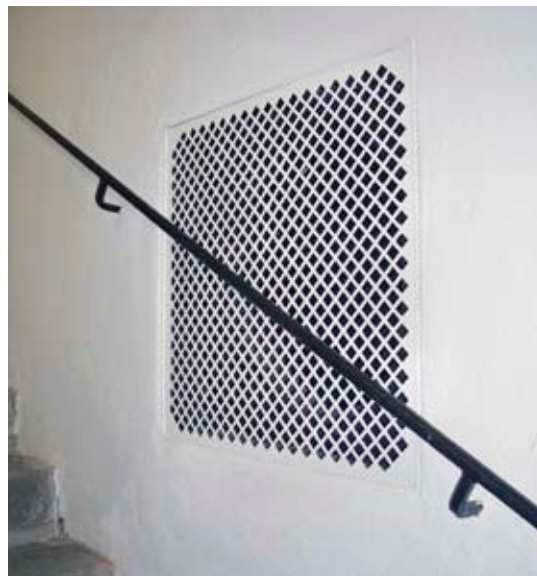
Bakom det nytillverkade gallret ligger tilluftsaggregatet. Luften renas och värms vintertid för att sedan blåsas ut genom gallret som finns längst ner i trapphuset.
