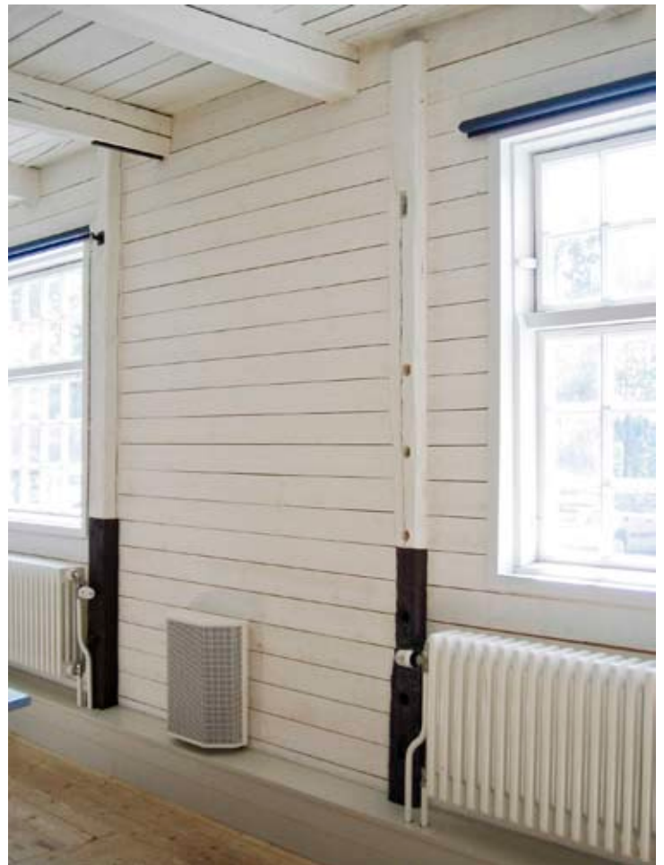
Luften tas in i lärosalarna via ventilkonvektorer som ger förvärmning vintertid.
