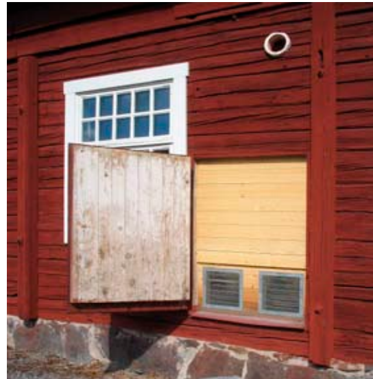
Tilluftsgaller i fasad som döljs av originallucka. Den f. d. dyngluckan har kapats i underkant. Springan är tillräckligt stor för att luft ska komma in när luckan är stängd.
