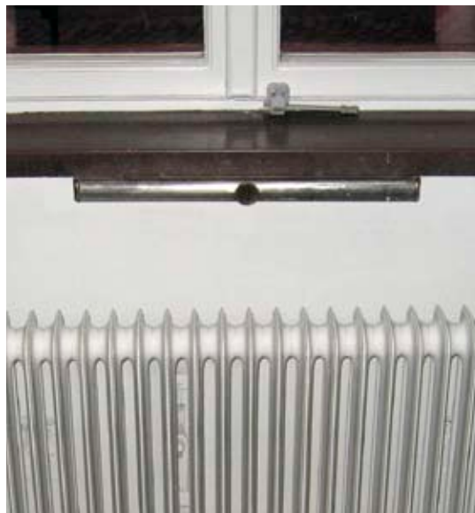
Spaltventil under fönsterbänk, vanlig från 1930-talet.
