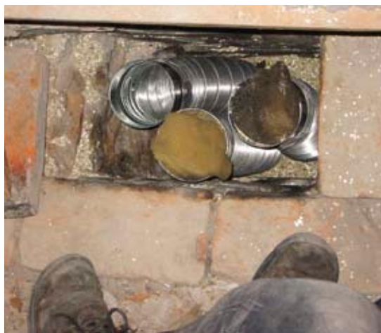
Vissa kanaler fodrades med flexibla plåtslangar omgivna av isolerande och stabiliserande material.
