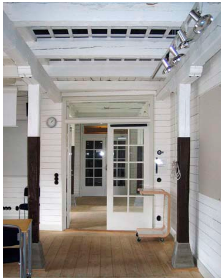
I den inre delen av denna lektionssal finns ett luftschakt i taket där en axialfläkt sitter. Fläkten startas av hyresgästen vid behov.
