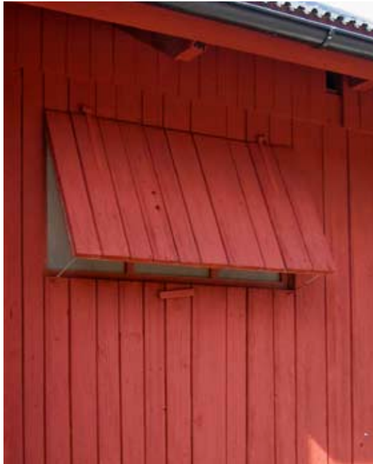
En befintlig lucka som ställs på glänt används som luftintag till värmekammaren (kalorifer) innanför föreläsningssalen.
