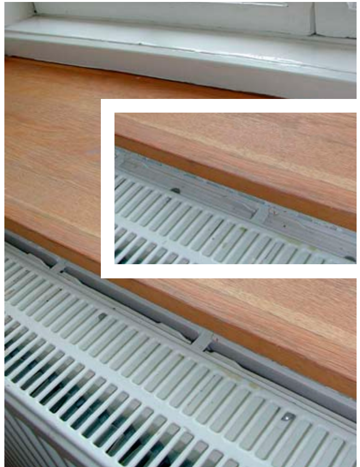
Uteluften leds in via hål i fasaden bakom radiatoren. På så vis förvärms luften. Den lilla bilden visar tillufts-gallret i radiatorn i stängt läge.
