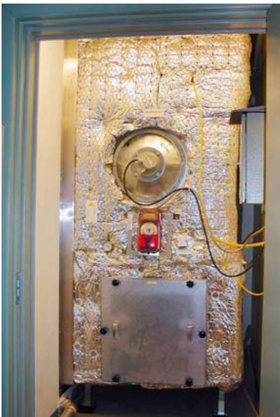
Frånluftsfläkten är placerad på vindsvåningen. Frånlufts-kanalerna i befintliga skorstenar sammanbinds på råvinden med horisontella plåtkanaler som leds ner till frånluftsfläkten.
