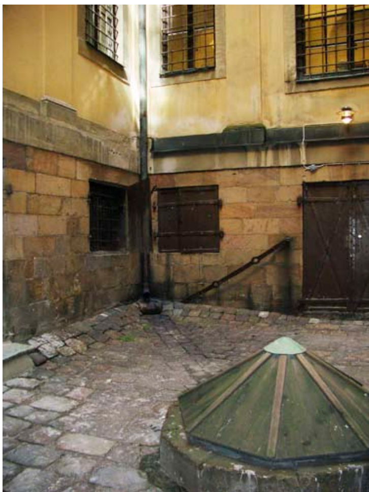
Bilden visar den västra gården som förser huvudtrapphuset med uteluft. Innanför gallret ligger fläktrummet med tilluftsaggregatet.
