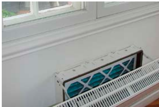
Uteluften tas in bakom radiatorn som är fällbar och har ett filter.
