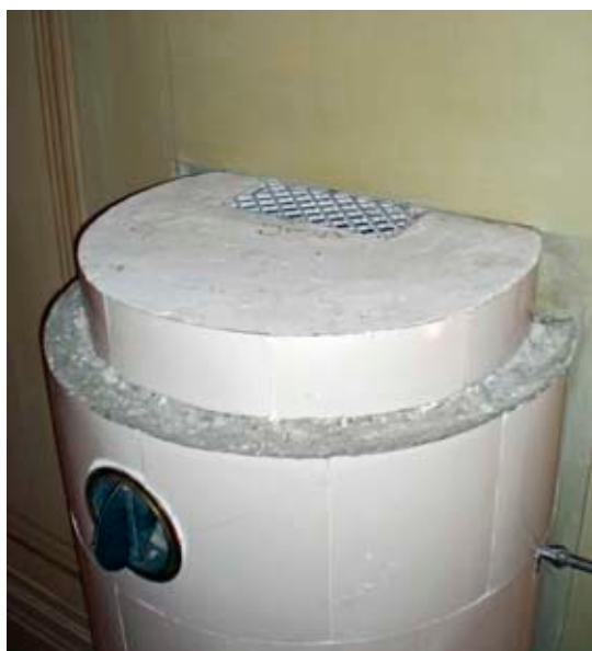
Kakelugnen i sessionssalen har kompletterats med frånluftsgaller på ovansidan. Koldioxidhalten i frånluftskanalen mäts kontinuerligt och frånluftsfloëdet forceras automatiskt vid behov.
