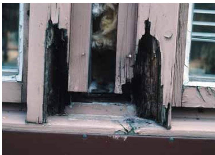
Rötskadat fönstervirke i en sju år gammal byggnad med fel konstruktionsutförande och där såväl fel virke som fel färg används.
