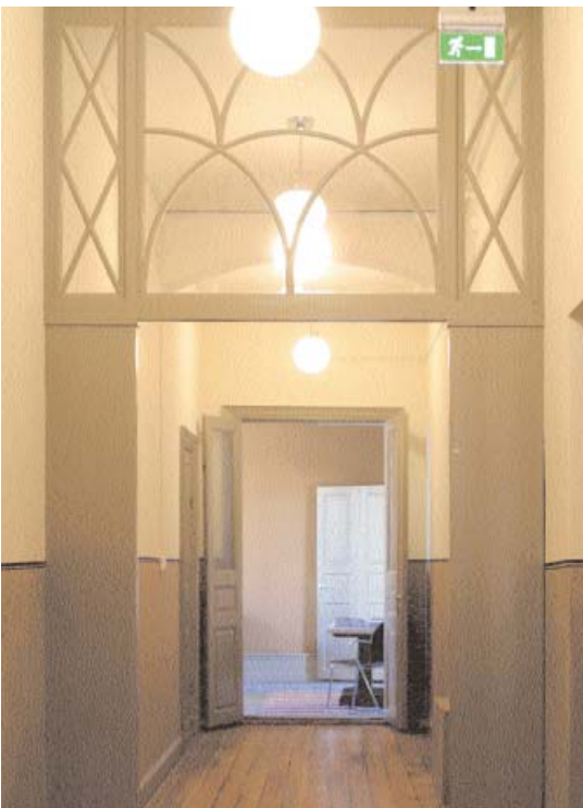
Väggar och snickerier har återfått sin ursprungliga färgsättning. Glaspartiet som varit dolt under spånplattor är åter framtaget.
