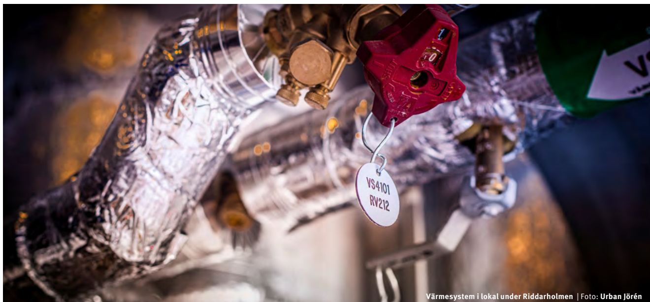
Värmesystem i lokal under Ridderholmen | Foto: Urban Jörén
