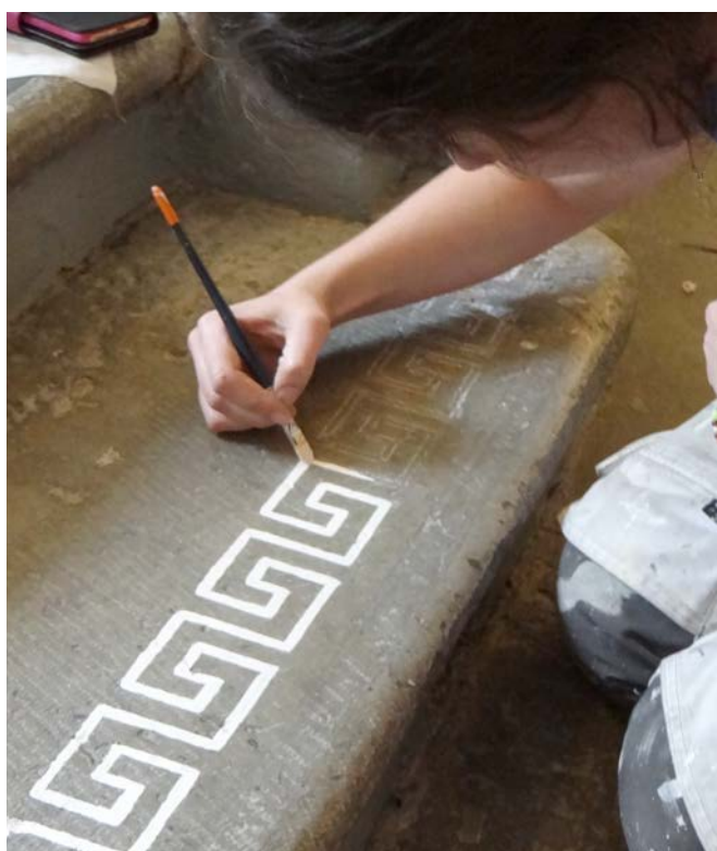
Handmålade meanderslingor i linoljefärg på trappstegen med hjälp av en mall i plåt.
